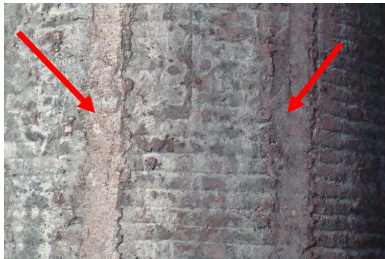
Fig.5.13 Urme vizibile pe suprafața semifabricatului
